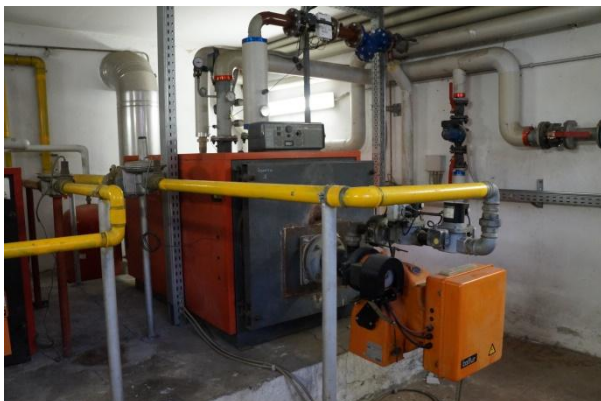
Figura 4.13 - Particolare del generatore installato in centrale termica
