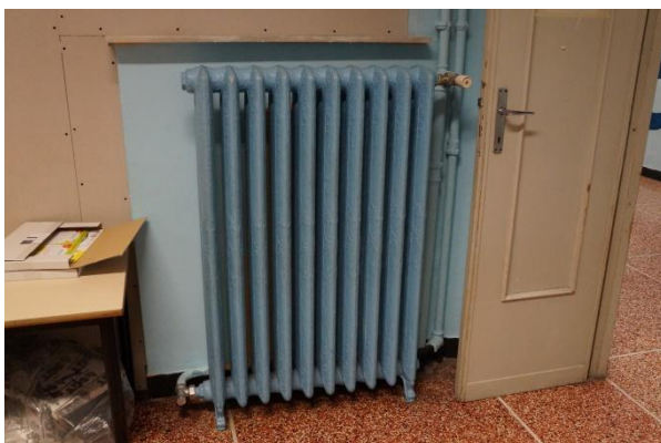
Figura 4.7 – Particolare di un radiatore installato all'interno di un'aula
