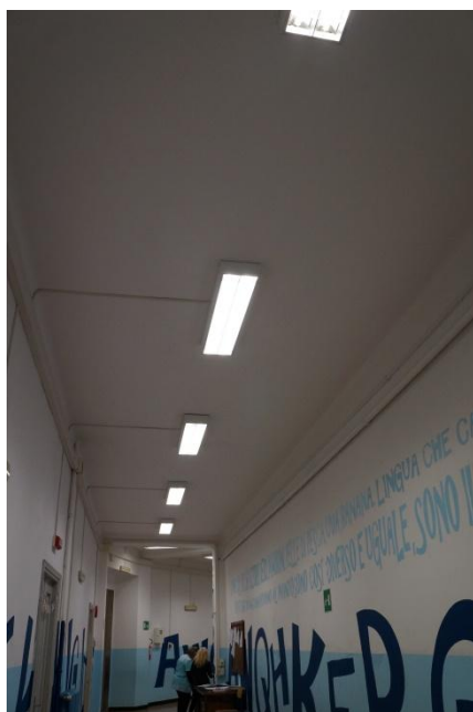
Figura 4.17 - Particolare dei corpi illuminanti ubicati lungo i corridoi
