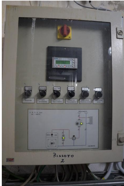
Figura 4.9 - Particolare del sistema di termoregolazione in CT
