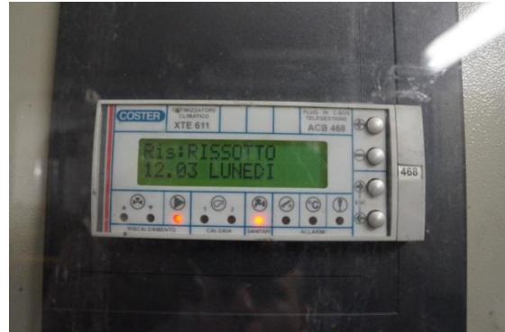
Figura 4.10 – Particolare della centralina di controllo in CT
