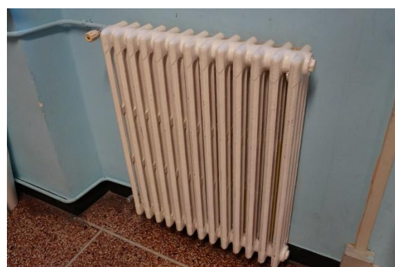
Figura 4.6 - Particolare di un radiatore installato in un corridoio
