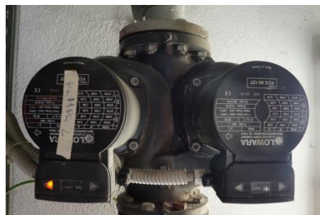
Figura 8.7 – Particolare pompe di circolazione
