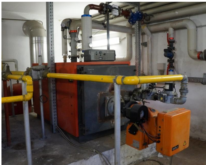
Figura 8.3 – Particolare generatore di calore esistente
