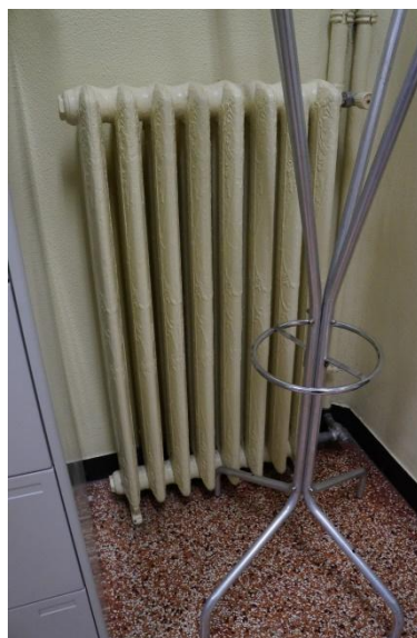
Figura 4.8 - Particolare di un radiatore installato in un disimpegno
