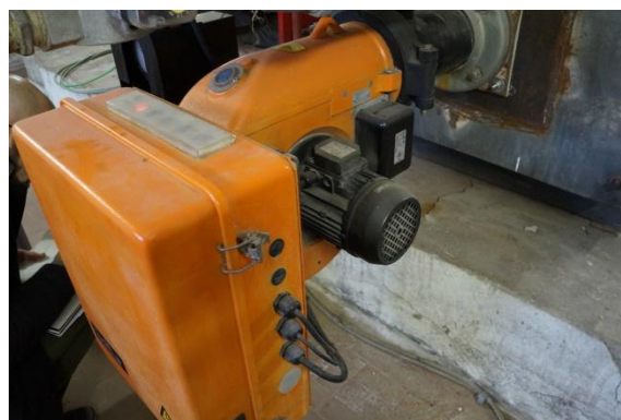
Figura 4.14 - Particolare del bruciatore a servizio del generatore di calore
