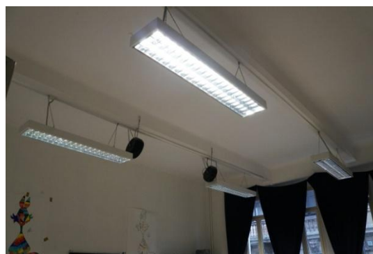
Figura 4.16 - Particolare dei corpi illuminanti ubicati nelle aule del piano terra
